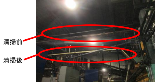
配線を渡しているラック
