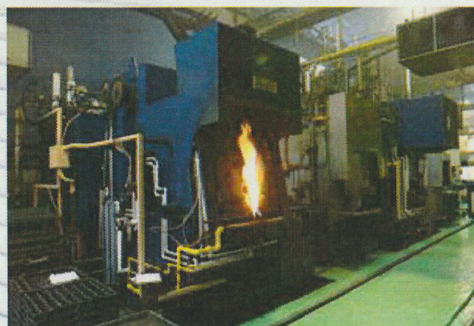
滴注式ガス浸炭炉 1基 有効寸法:600W×600H×1,200L ※油冷却(ホット・クエンチ可)
